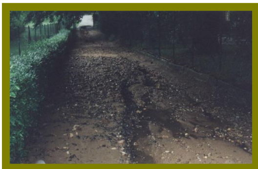
Schäden am Fährweg
