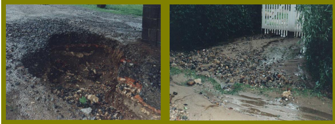
Schäden im Innenbereich des Tores zum Fährweg
