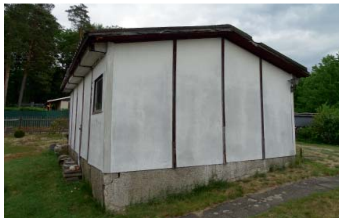
Klassische Asbestlaube aus DDR-Zeiten. Da die Dachplatten beschädigt sind, müssen die Asbestplatten entfernt werden. Bei der Demontage und der Entsorgung sind gesetzliche Vorgaben einzuhalten!
